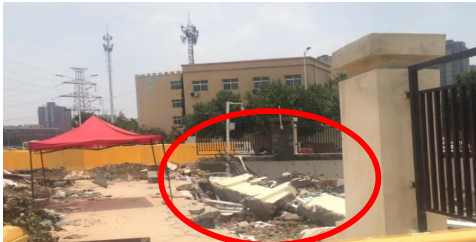
挡水墙被冲垮
