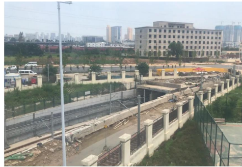
五龙口停车场隧道口敞开且顶板低于市政道路
