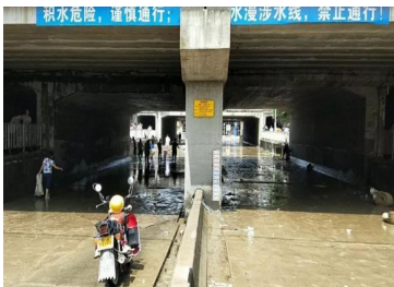
北京市某隧洞桥涵设置积水警示标尺与预警提示
